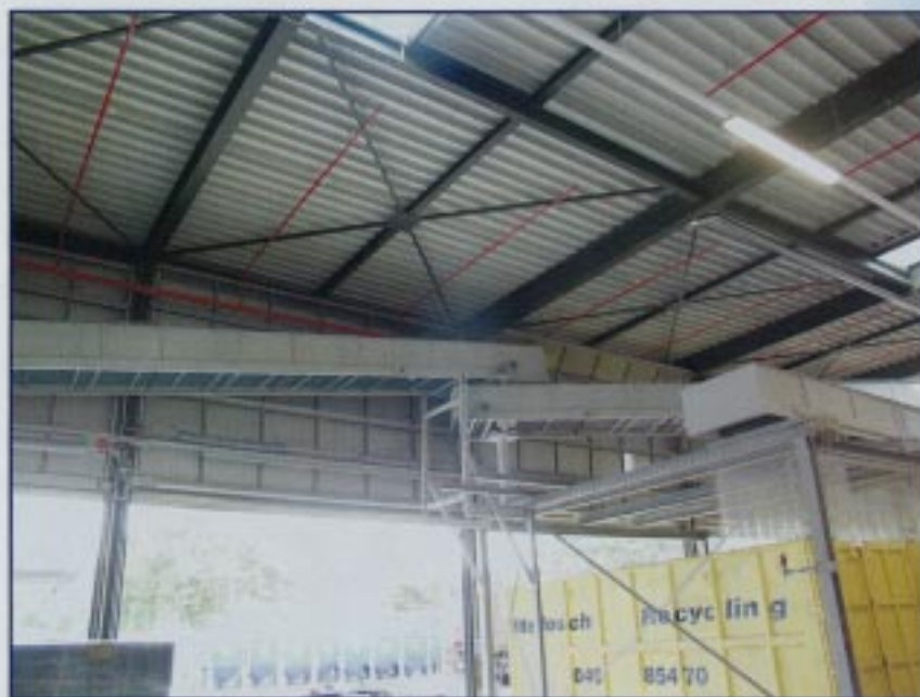
In der offenen Entsorgungsstation werden 5 Großcontainer über den Brückenverteiler mit Makulaturpapier gleichmäßig befüllt.
