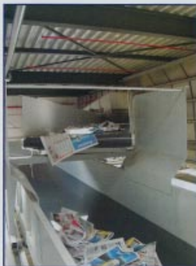
Blick auf den Brückenverteiler oberhalb der Makulaturcontainer: Er verteilt das Papier in die jeweiligen Container.
