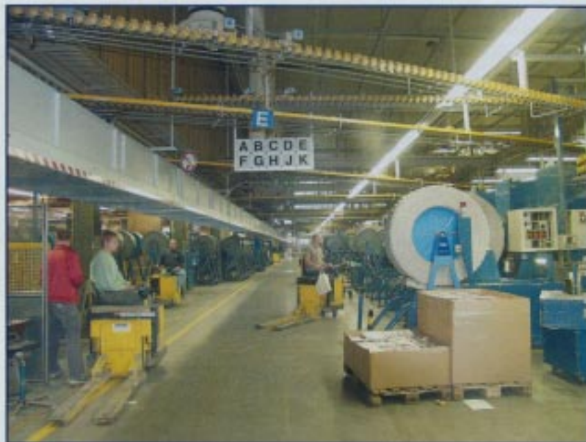
Längs durch die Druckereihalle läuft der 170 m lange Gurtförderer und nimmt die von den Förderanlagen abgeworfene Makulatur sicher auf.
